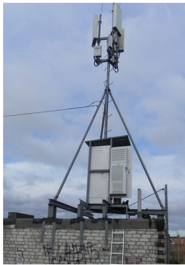
Рис. 8. Антенны и аппаратная, смонтированные на опоре
